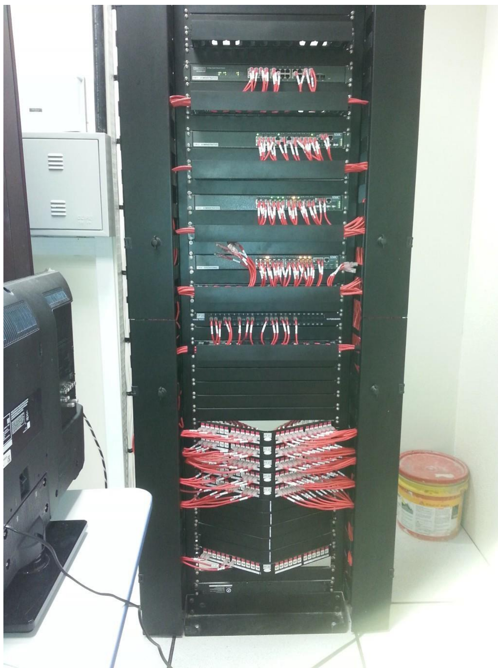
Figura 1.9: Foto de exemplo 2 montagem rack aberto.
