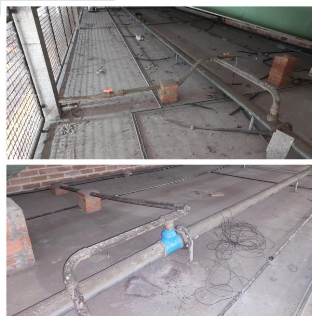
Figura 3 - Tubulação consumos existente
